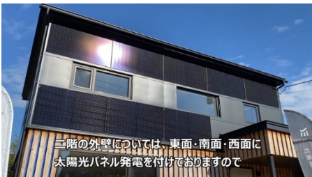
壁面の太陽光パネル
