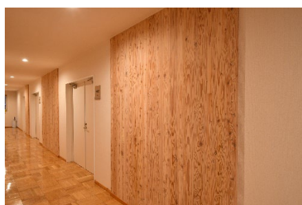
CLTによる構造耐力壁
