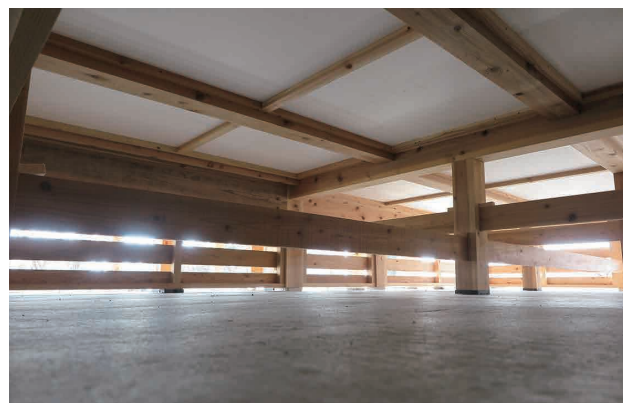
開放的で維持管理が容易な石場建ての床下
